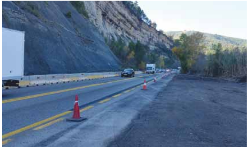
Tram de la C-55 de Castellgalí a Manresa, afectat per les obres
